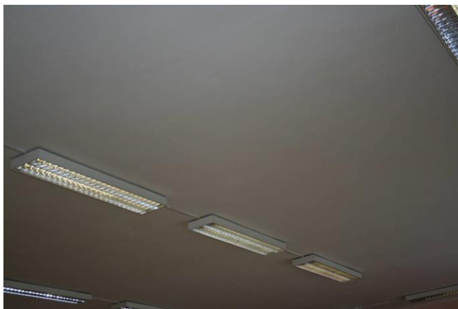
Slika 6.6: Posnetek učilnice s fluorescentnimi sijalkami 2 x 25 W in nadometne instalacije
