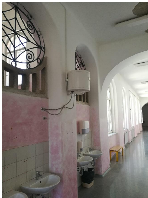
Slika 5.6: Posnetek električnega bojlerja na hodniku Vir: lastni vir.
