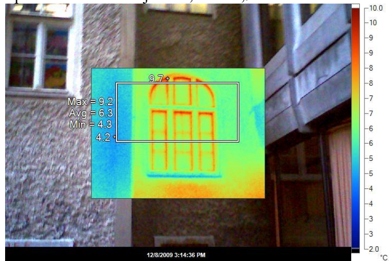
J stran – učilnica (detajl okna) - problematični okvirji oken, dT = 4,9\text{ }^{\circ}\text{C}
