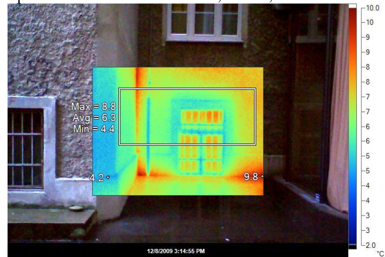
J stran – pritličje zgradbe (detajl okna) - problematična zasteklitev oken, dT = 4,4\text{ }^{\circ}\text{C}
