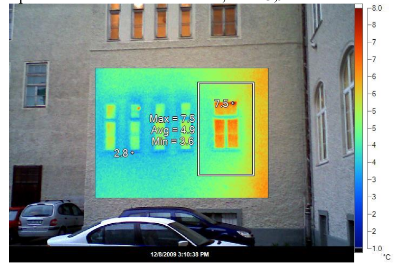
SZ stran – učilnica (detajl okna) - problematična zasteklitev oken, dT = 3,9\text{ }^{\circ}\text{C}
