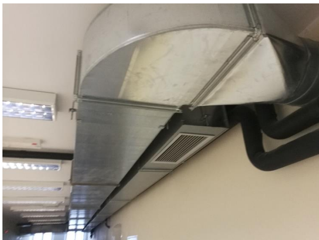
Slika 6.9: Posnetek prezračevalnih kanalov v jedilnici
