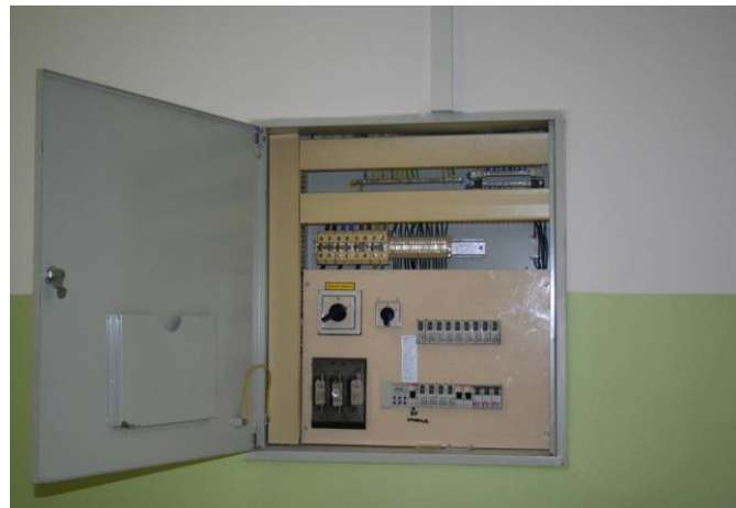
Slika 5.10: Posnetek glavnega razdelilnika na hodniku pritličja
