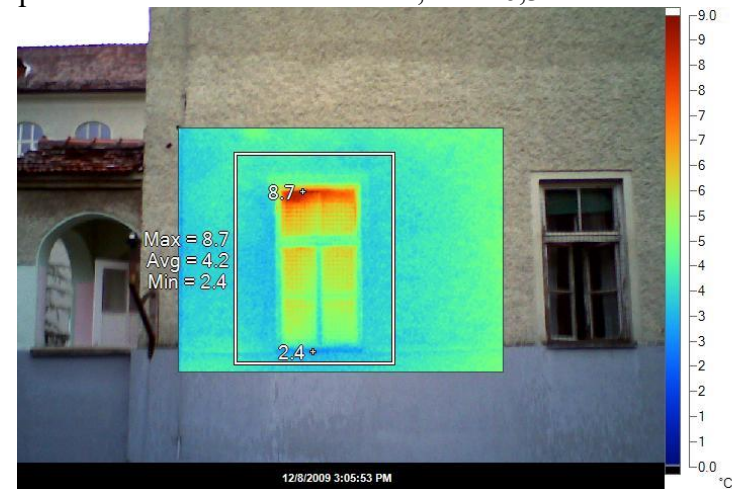
Z stran – hodnik učilnica (detajl okna) - problematična zasteklitev oken, dT = 6,3\text{ }^{\circ}\text{C}
